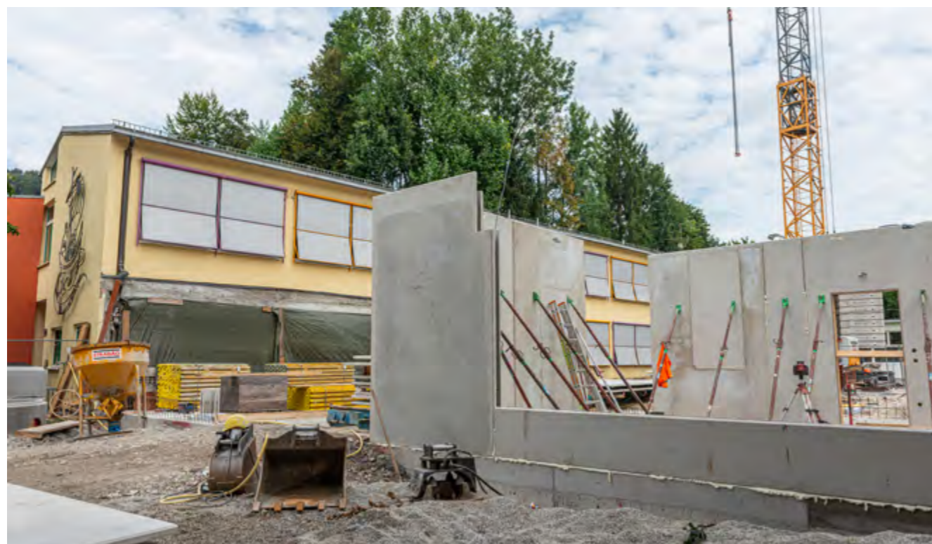
Neben generalsanierter Eingangshalle, Werkraum und Umkleide gibt es dank des neuen Zubaus viel Platz für die Ganztagsbetreuung an der Volksschule Parsch
